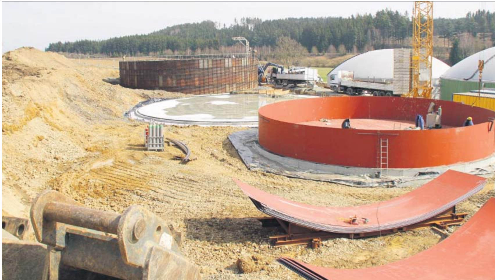
Vor einigen Tagen haben Arbeiter damit begonnen, den großen Fermenter aus Stahl zusammenschweißen – in ihm gärt die Biomasse.
